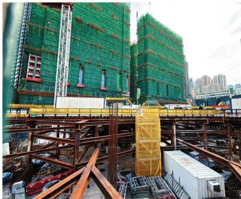
■大埔宏福苑火災慘劇後，工人在建築地盤及現有樓宇維修時的吸煙問題備受社會各界關注。
